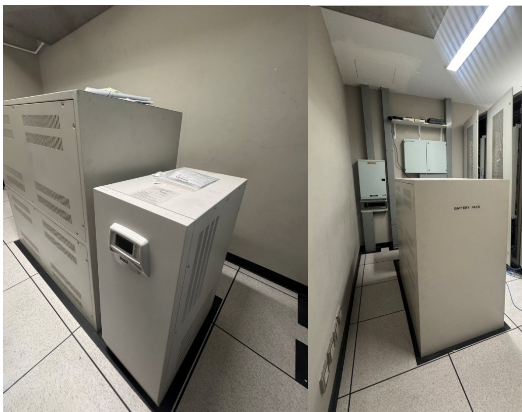
ภาพที่ 2.14 เครื่องสำรองไฟฟ้า (Uninterruptible Power Supply: UPS) ขนาด 15 kVA
