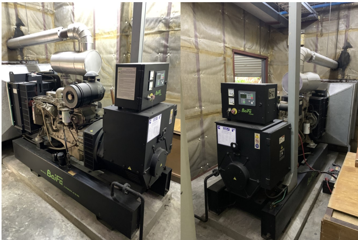
ภาพที่ 2.15 เครื่องกำเนิดไฟฟ้าสำรองของสหกรณ์ (Generator)
