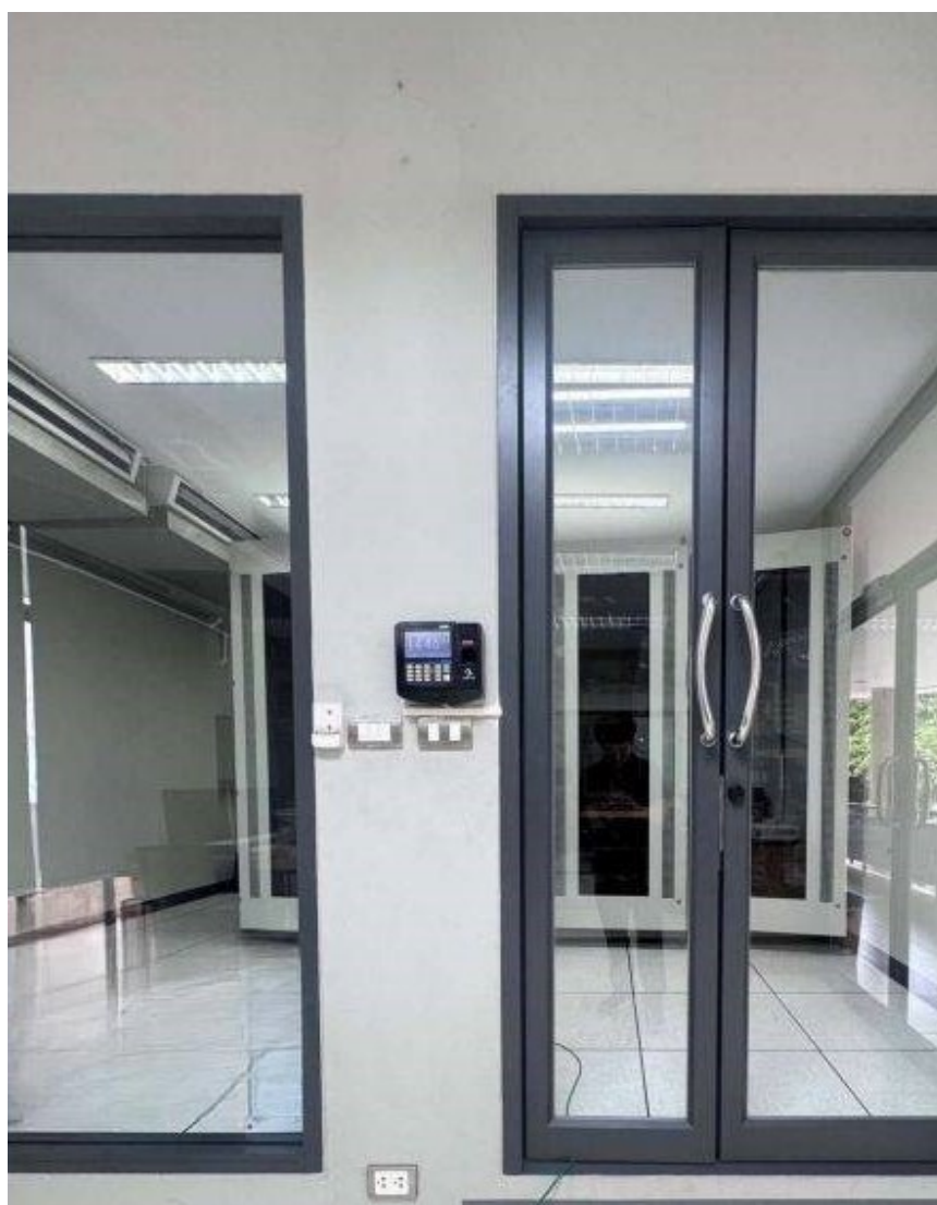
ภาพที่ 2.13 ห้องเครื่องแม่ข่าย (Server Room)
